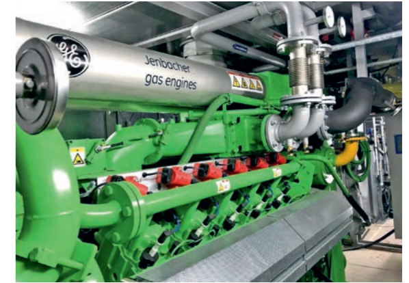
Das bei der Vergärung entstehende Methangas wird in den anlageneigenen Blockheizkraftwerken zur Strom- und Wärmegewinnung genutzt.
